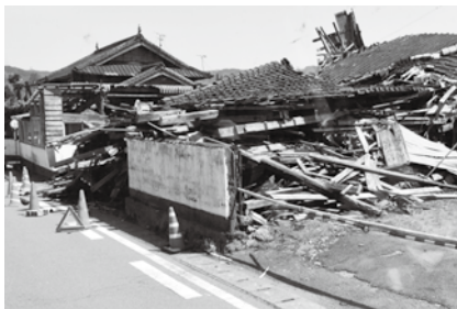
熊本地震で倒壊した家
