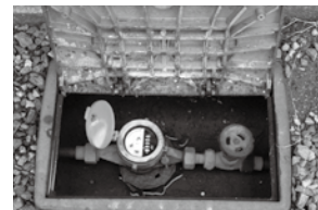
地下式メーター
