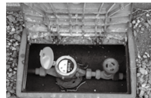
地下式メーター
