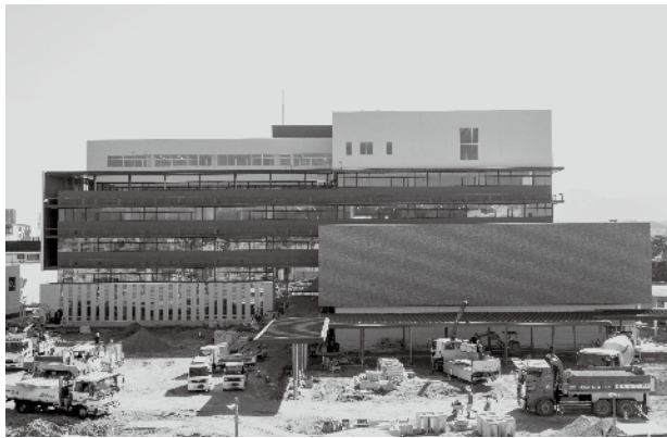
来年1月の移転に向け、市庁舎建設を進めています(10月25日撮影)
