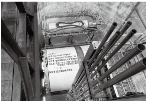
地上から約20メートル下の立坑内で発進を待つシールドマシン
