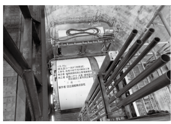
地上から約20メートル下の立坑内で発進を待つシールドマシン
