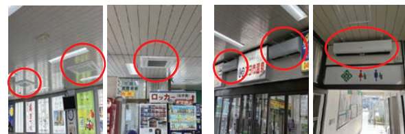
設置したエアコン (4か所)
