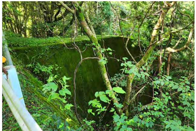
写真 48 防災施設 (砂防ダム)
