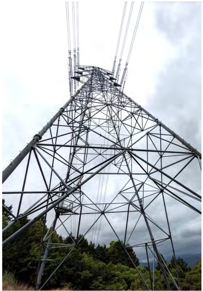
写真 57 高圧送電用鉄塔
