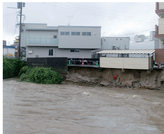
▲水害（護岸崩壊）
