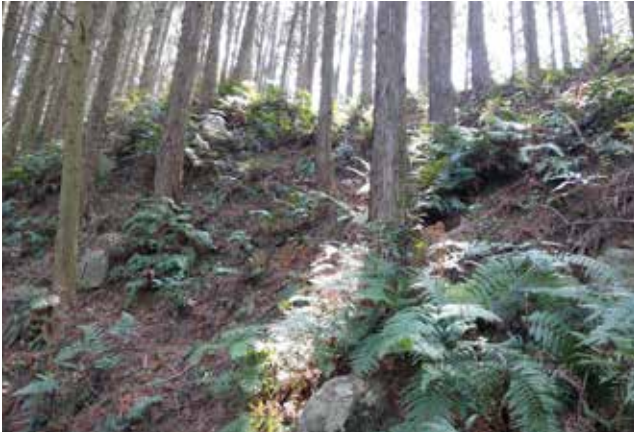
写真 68 ⑮斜面崩壊
