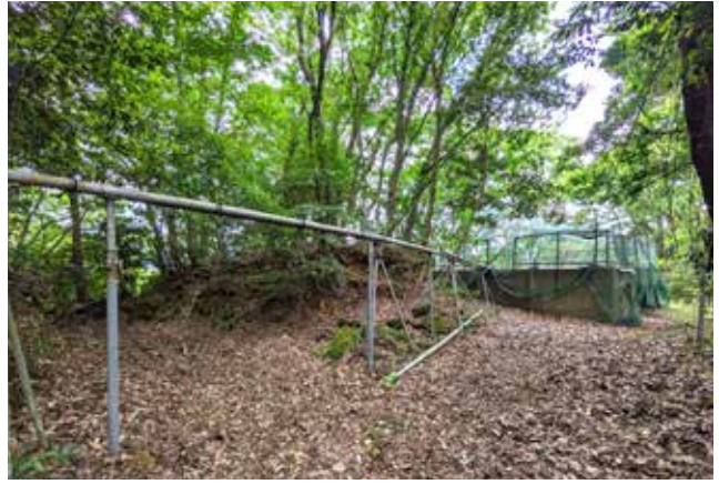
写真 54 福岡県農林業総合試験場取水設備
