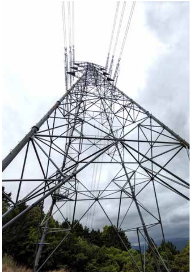
写真 57 高圧送電用鉄塔
