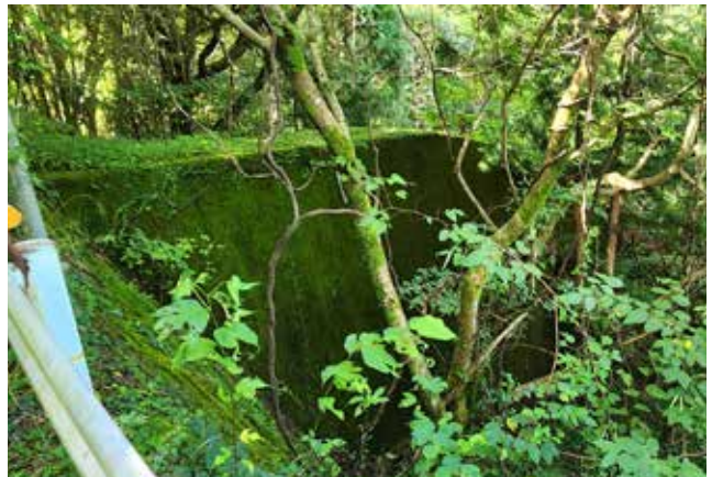
写真 48 防災施設（砂防ダム）
