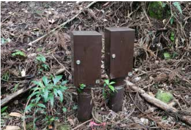
写真 58 高圧送電用鉄塔付帯設備
