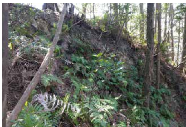
写真 62 ④斜面崩壊 (土塁欠損)
