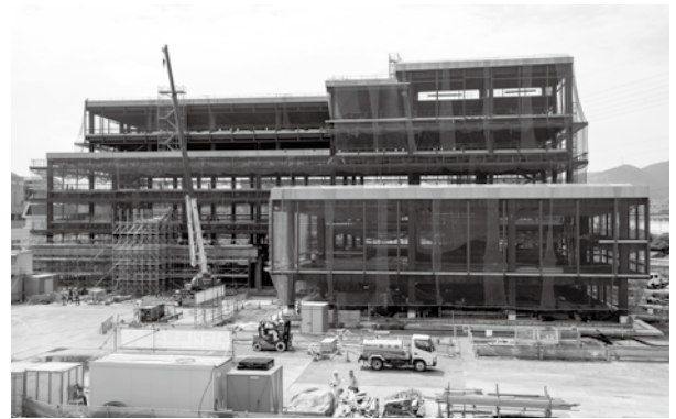
市庁舎建設では、各階の床のコンクリート打設が完了し、配管などの内部工事に着手しています
