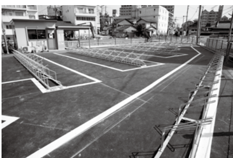
到達立坑の工事のため、西鉄二日市駅自転車駐車を移設しています
