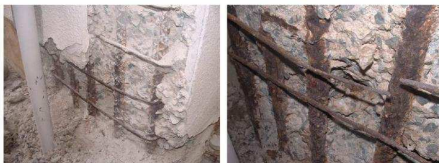
鉄筋の破断状況
