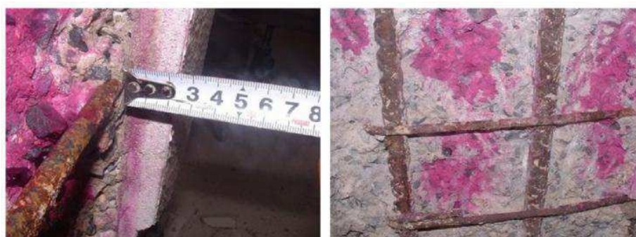
コンクリート腐食状況
