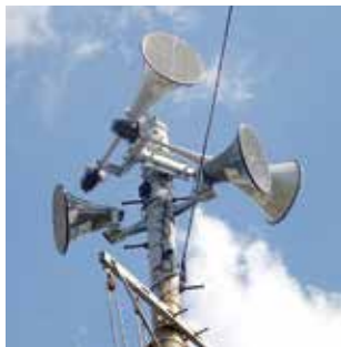
整備した屋外スピーカー
