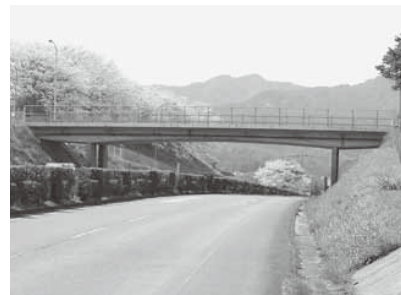
橋りょうの調査と維持補修を計画的に実施しています
