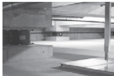
▲免震構造部分。建物の基礎部分にゴム層などを入れ、振動が建物に伝わらない仕組みになっています。写真右側は、揺れを記録する装置。
