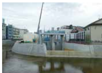
高尾川地下河川流出施設
