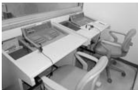
電話交換室（本庁舎）
