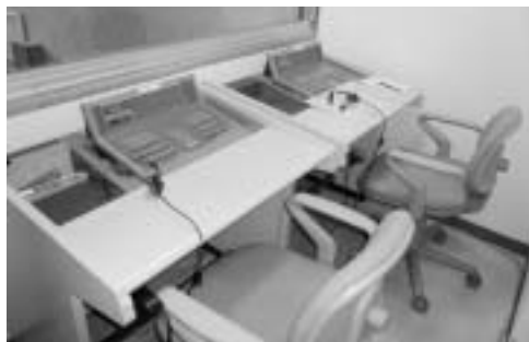
電話交換室（本庁舎）
